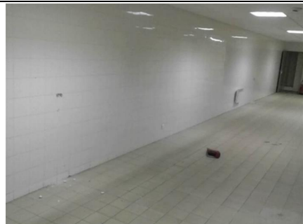
Photo n° PhA006 Localisation : Bureaux - RDC Ouvrage : 3 - Parois verticales intérieures - Revêtements de murs, poteaux, cloisons, gaines, coffres Partie d'ouvrage : Colle de faïence Description : Matériau dur de type ciment-colle (beige) ; matériau souple fibreux de type papier, carton (marron) ; matériau semi-dur (blanc)
