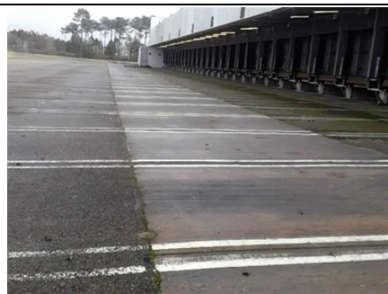
Photo n° PhA039 Localisation : Extérieur Ouvrage : 10 - Aménagements, voiries et réseaux divers Partie d'ouvrage : -quai Description : joint bitume
