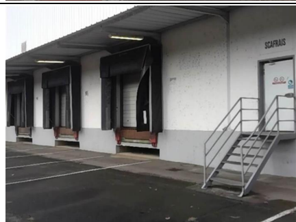
Photo n° PhA043 Localisation : Extérieur Ouvrage : 2 - Parois verticales extérieures et Façades - Façades lourdes y compris poteaux Partie d'ouvrage : Enduit extérieur (projeté, lissé ou taloché) Description : Enduit extérieur (projeté, lissé ou taloché)
