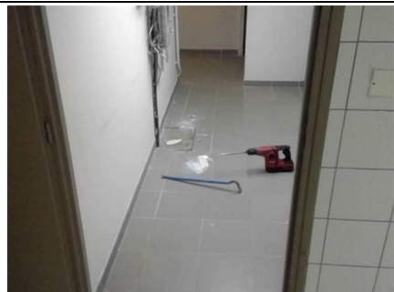
Photo n° PhA008 Localisation : Bureaux - RDC Ouvrage : 5 - Planchers et planchers techniques - Revêtements de sols Partie d'ouvrage : Ragréage Description : Ragréage
