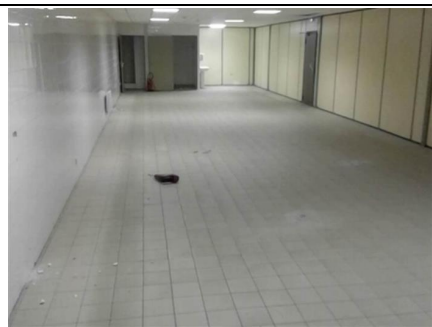
Photo n° PhA005 Localisation : Bureaux - RDC Ouvrage : 5 - Planchers et planchers techniques - Revêtements de sols Partie d'ouvrage : Colle de carrelage Description : Colle de carrelage
